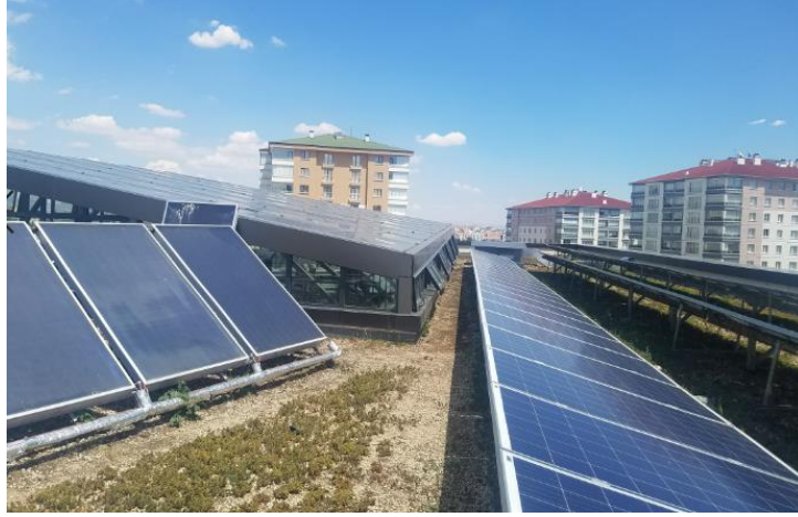
Şekil 52 Ankara Sincan-Etimesgut Tapu ve Kadastro Genel Müdürlüğü Hizmet Binası Çatısına Kurulmuş Güneş Enerjisi Sistemleri
