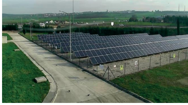
ŞEKİL4-6: BATI ATIKSU ARITMA TESİSİ GÜNEŞ PANELLERİ
