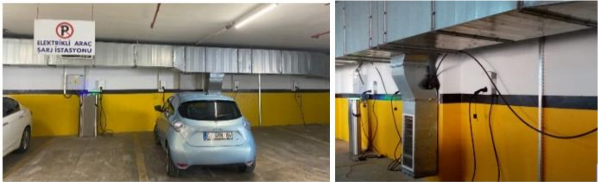
Şekil 4.87. Elektrikli araç şarj istasyonu
