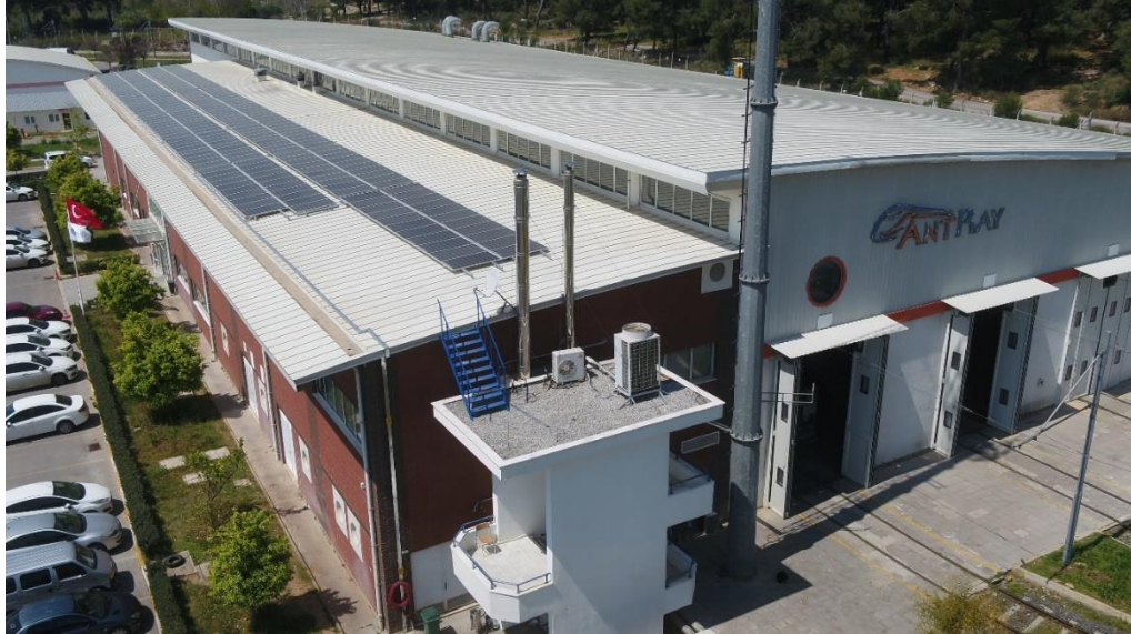
Şekil 4.81. Antalya Ulaşım A.Ş. binası çatı tipi GES (Antalya Büyükşehir Belediyesi, 2023b)
