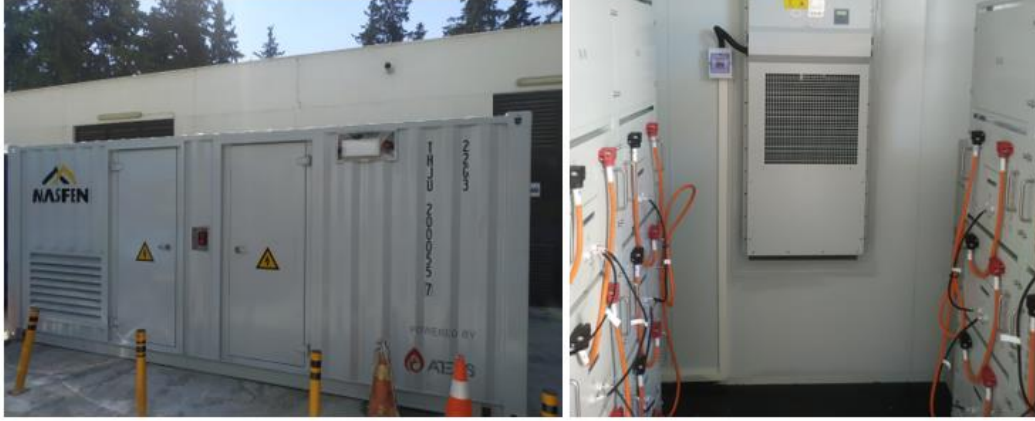
Şekil 4.79. Antalya Büyükşehir Belediyesi Ana Hizmet Binası GES depolama sistemi
