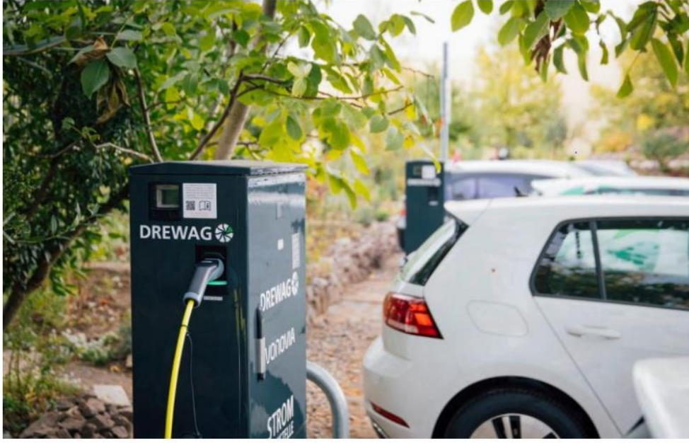
Şekil 4.57. Elektrikli araç şarj istasyonu (Anz vd., 2021)
