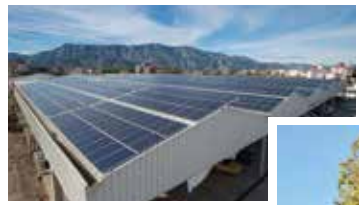
5MWp Kapasite Güneş Tarlası (Döşemealtı)
